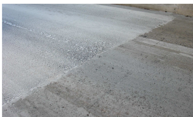
Fig. 38 - Giunto tra le due pavimentazioni – In primo piano la malta riportata sopra la pavimentazione
