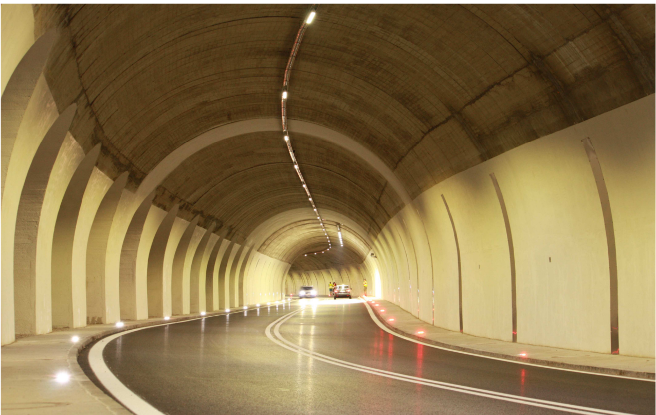
Fig. 33 - Galleria Seehoftunnel: illuminazione LED nelle zone di entrata e all'interno della galleria e elementi guida sulla corsia laterale
