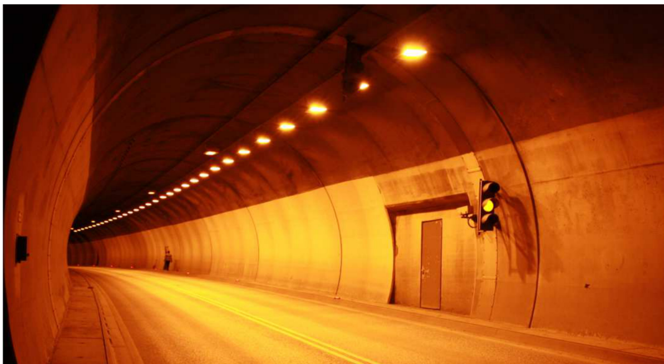
Fig. 54 - Le aree pilota iniziano dopo il locale tecnico verso il centro della galleria
